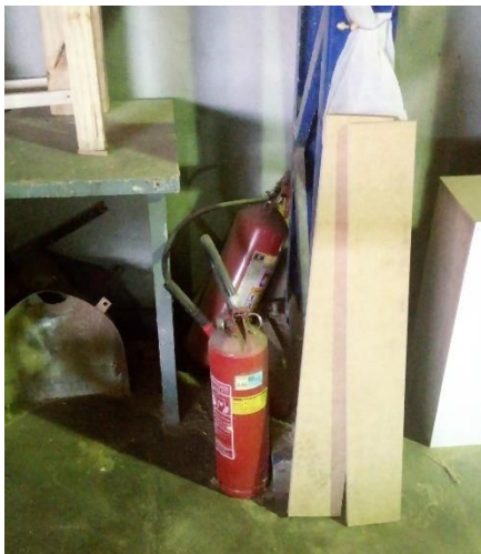
Figura 8 - Extintores de incêndio obstruídos e sem sinalização
